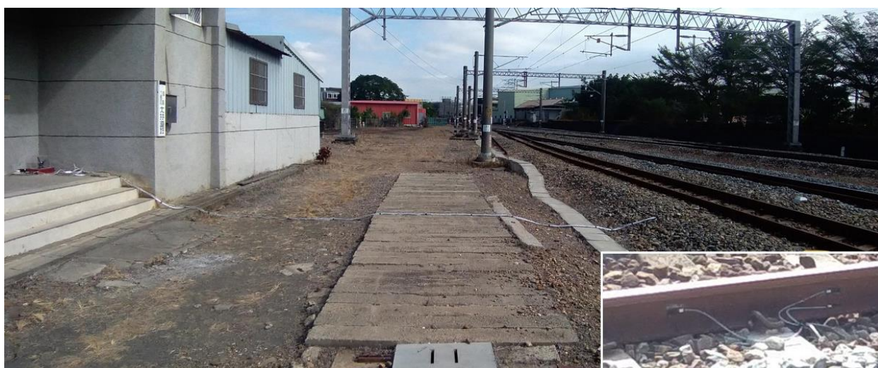
Obr. 4: Instalace finální verze IoT snímačích zařízení na železniční trati na Taiwanu, vpravo dole detail na umístění 4 snímačů vibrací
